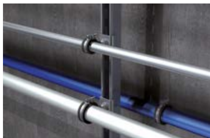
Szerelősínre szerelt csővezeték
